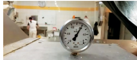
■ W trakcie przeglądu serwis wykonuje pomiar ciśnienia (szczelności) sekcji dzielącej specjalnym urządzeniem.
